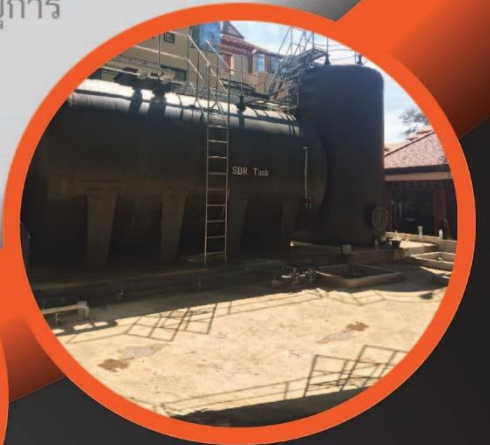
ระบบบำบัดน้ำเสียแบบ ASBR ของ โรงแรม ลาภูน้ำ บ้านยันตรี จ. ภูเก็ต
