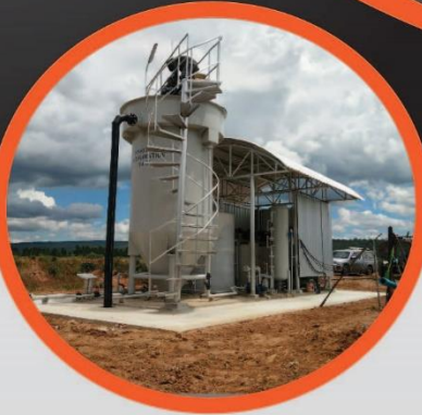
ระบบบำบัดน้ำเสียแบบ Dissolved Air Flotation ของบริษัท ซีพีเอฟ (ประเทศไทย) จำกัด (มหาชน)
